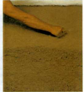
... und fertig ist die unsichtbare Nachtspeicherheizung.
